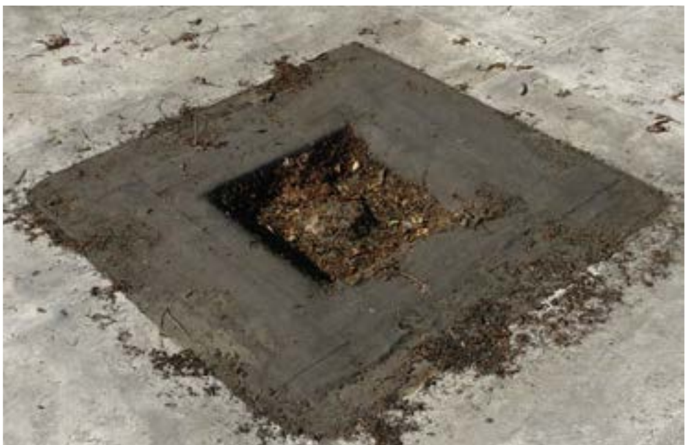
Abb. 27 Dachablauf des gefällelosen Flachdaches (verstopft, Laubgitter fehlt, Wartung erforderlich)
