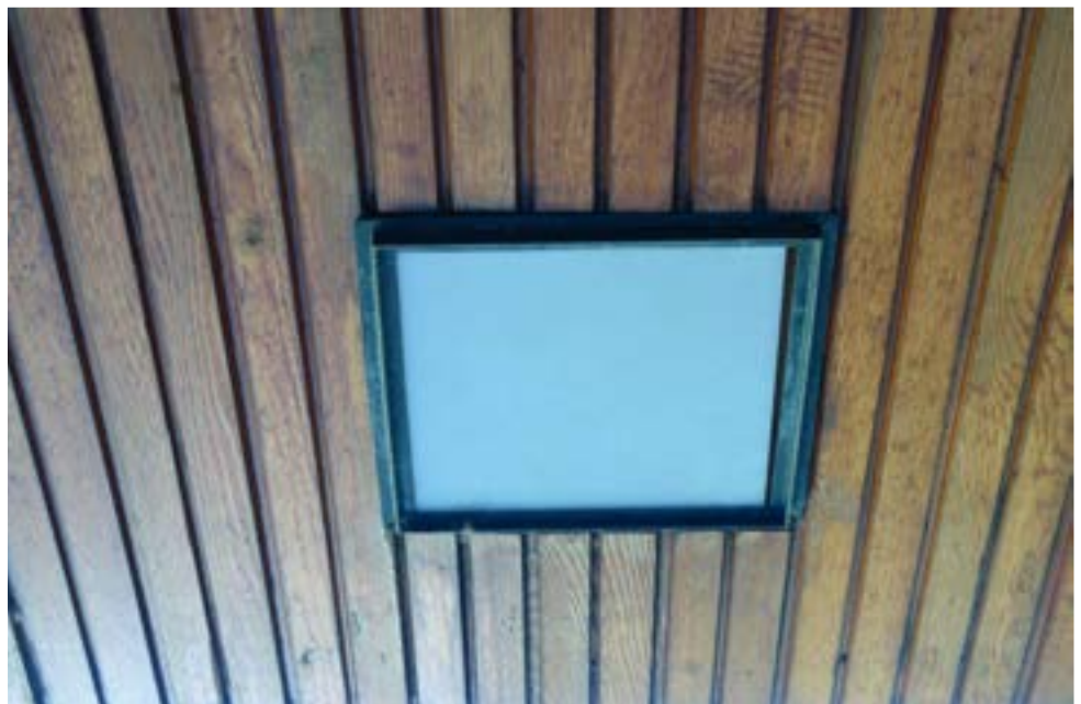
Abb. 47 Stahlgefaßte Einbauleuchte oberhalb Eingangsbereich Haustür
