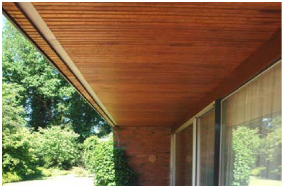
Abb. 46 Einbaulichtband im Dachüberstand der Terrassen
