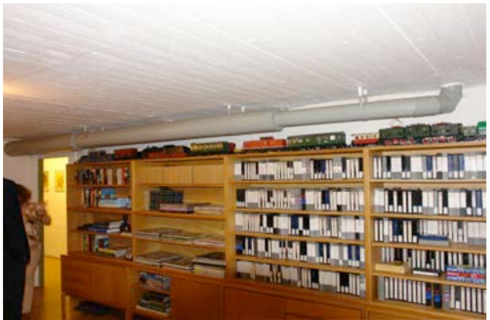
Abb. 43 Warmluftleitungen im Keller für Luftauslaß im Wohnraum (nicht wärmegeklämt) Nr. 16
