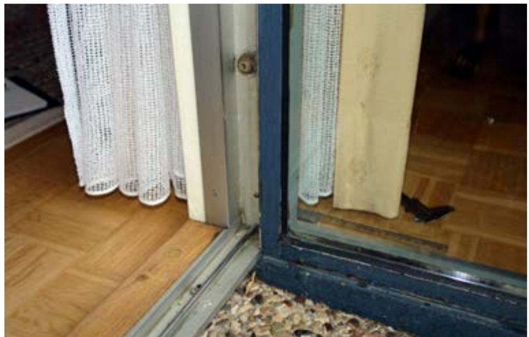
Abb. 37 Innenecke Schiebetür - Festverglasung (in stark korrodiertem Stahlrahmen)
